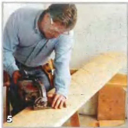
Пропилы за линией разметки излишне ослабляют тетиву. Поэтому первые запилы, выполненные дисковой пилой, должны не доходить до пересечения линий
